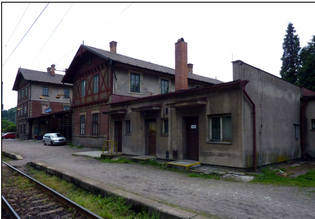
Foto 77 Přízemní přístavek na parcele č. 785 pro vlakové čety a WC. Přístavek zohyzďuje historickou výpravní budovu, s níž je spojen plochou střechou vytvářející jakýsi průchod.
