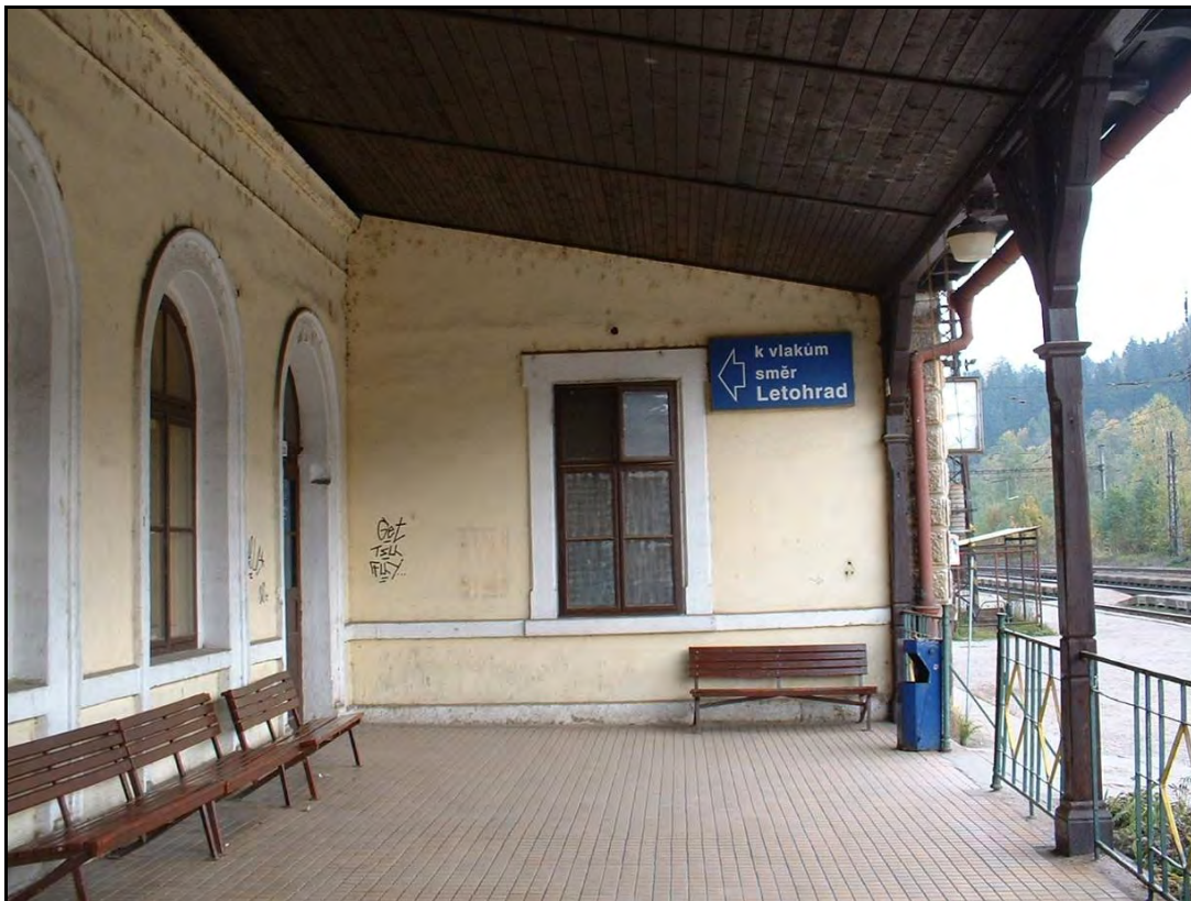
Foto 23 Pohled na západní fasádu v přízemí východního křídla v ploše jižního nástupiště. Dlažba perónu novodobá. Zábradlí snad původní, z doby výstavby budovy. Foto 6/2011.
