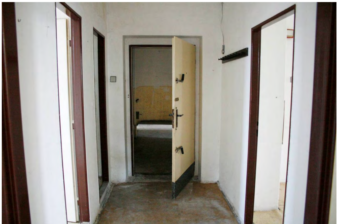
Foto 50 Prostor 209. Pohled směrem ke schodišti. Na fotografii jsou zachyceny nově vestavěné prostory po obou stranách bytu. Foto 6/2011.
