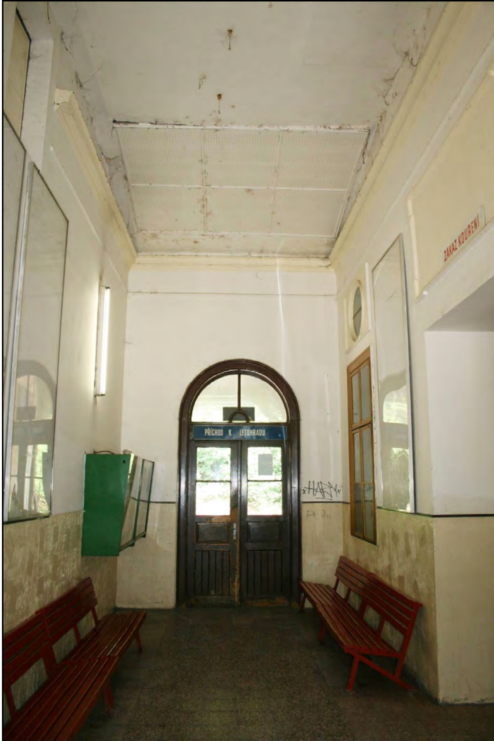
Foto 34 Prostor 102. Pohled do interiéru spojovací chodby mezi oběma nástupišti. Na pravé straně je vidět obdélné a menší kruhové okno osvětlující vnitřní schodiště. U stropu na proavé straně je jednoduchý obdélný vstup do prostoru krovu spojovací křídla. Na stropě je vidět zaslepený otvor po jednom ze světlíků. Podle nejnovějších nálezů v podstřeší středního křídla ( foto 80 – 82 ) je zřejmé, že stávající strop byl vložen druhotně a zároveň že původně i v průchodu byl otevřený průhled do krovu. Foto 6/2011.
