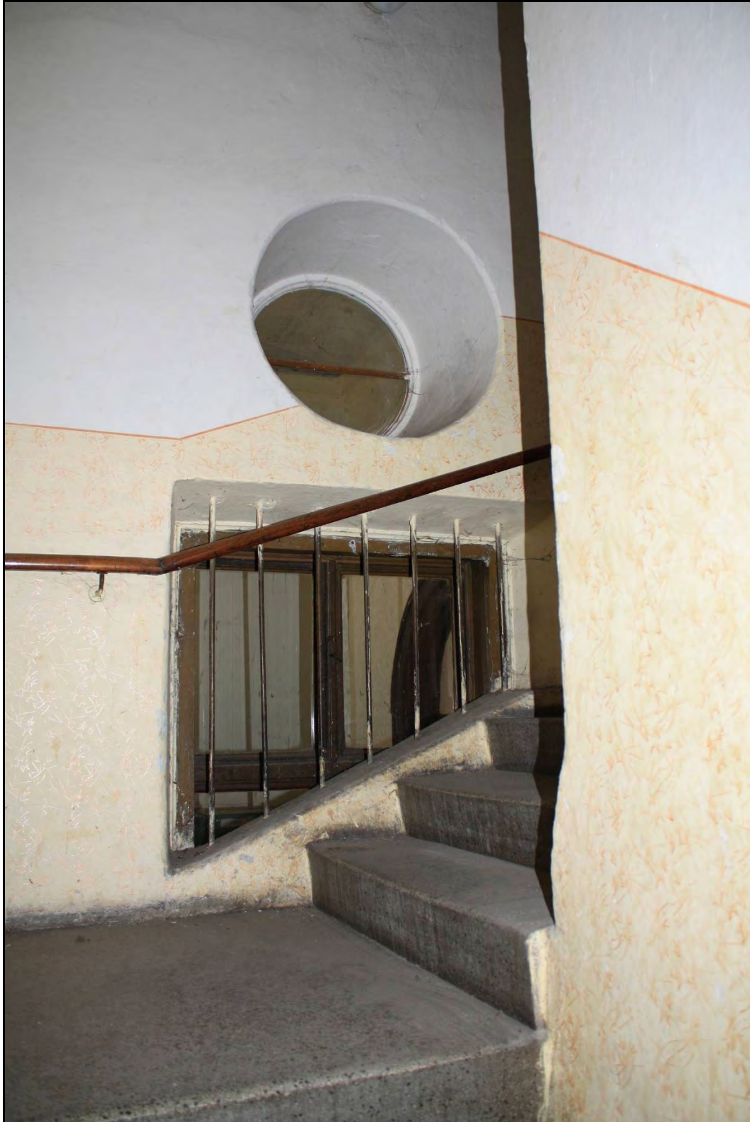
Foto 38 Prostor 113 . Detail nástupu na první podestu schodiště ve východní křídle. V pozadí vidíme okna přisvětlující schodiště z prostoru 102 . Foto 6/2011.
