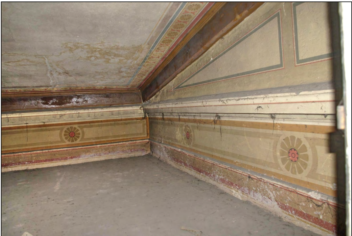
Foto 82 Detail dekorativní výmalby stěn severovýchodního kout nad mítností 115. Výmalba provedená patrně podle šablon se nachází pod i nad obíhající štukovou profilovanou římsou. Do omítaného podhledu s malovaným dekorativním rámem zasahují krokve nízké sedlové střechy středního křídla. Foto 29. 7. 2011.
