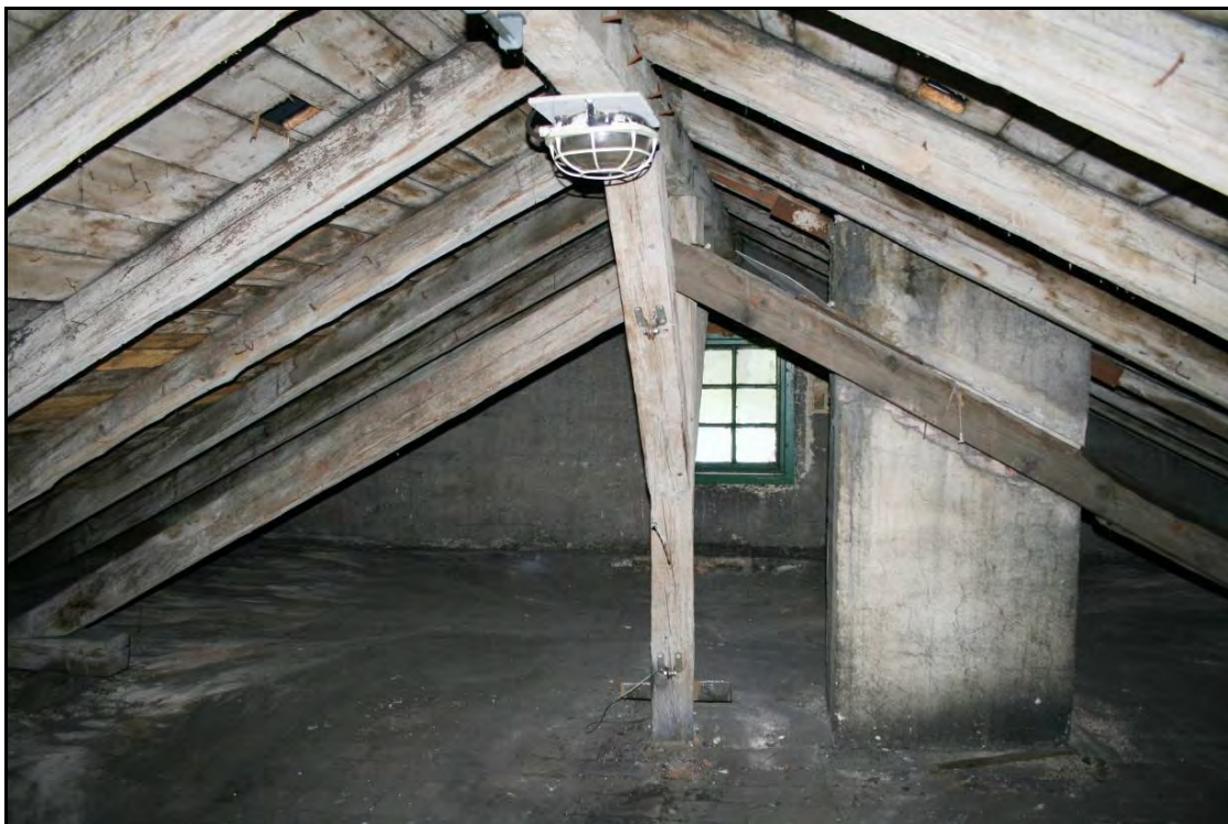
Foto 68 Prostor 321, podkroví západního křídla. Krov nízké sedlové střechy je původní, vaznicový, nepochybně z doby výstavby budovy. Tvoří jej soustava krokví s prahovými vaznicemi na podezdívce, podepřená průběžnou hřebenovou vaznicí, nesenou hranolovými sloupky se šikmými vzpěrami. Z boků jsou sloupky ještě podepřeny pod úrovní krokví šikmo kladenými vzpěrami. Na krokvích nabíjena prkna na sraz.
