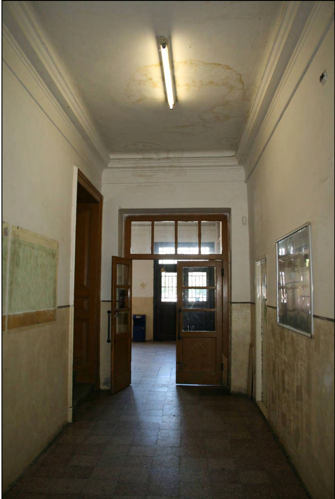
Foto 33 Prostor 102. Pohled směrem ke vstupní hale 101. Vlevo je vstup ke schodišti vedoucímu do pater východního křídla. Pod stropem obíhá štuková římsa. Foto 6/2011.
