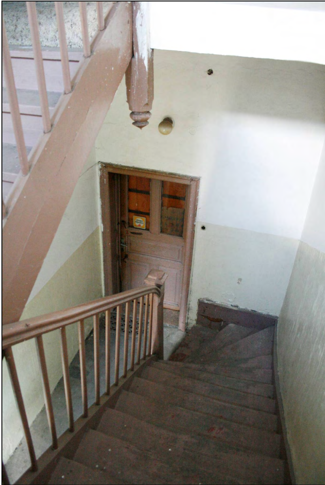
Foto 44 Prostor 126. Pohled ze schodiště na vstup z prostoru 125. V horní části snímku je vidět vysutý věšadlový sloupek konstrukce schodiště. Foto 6/2011.
