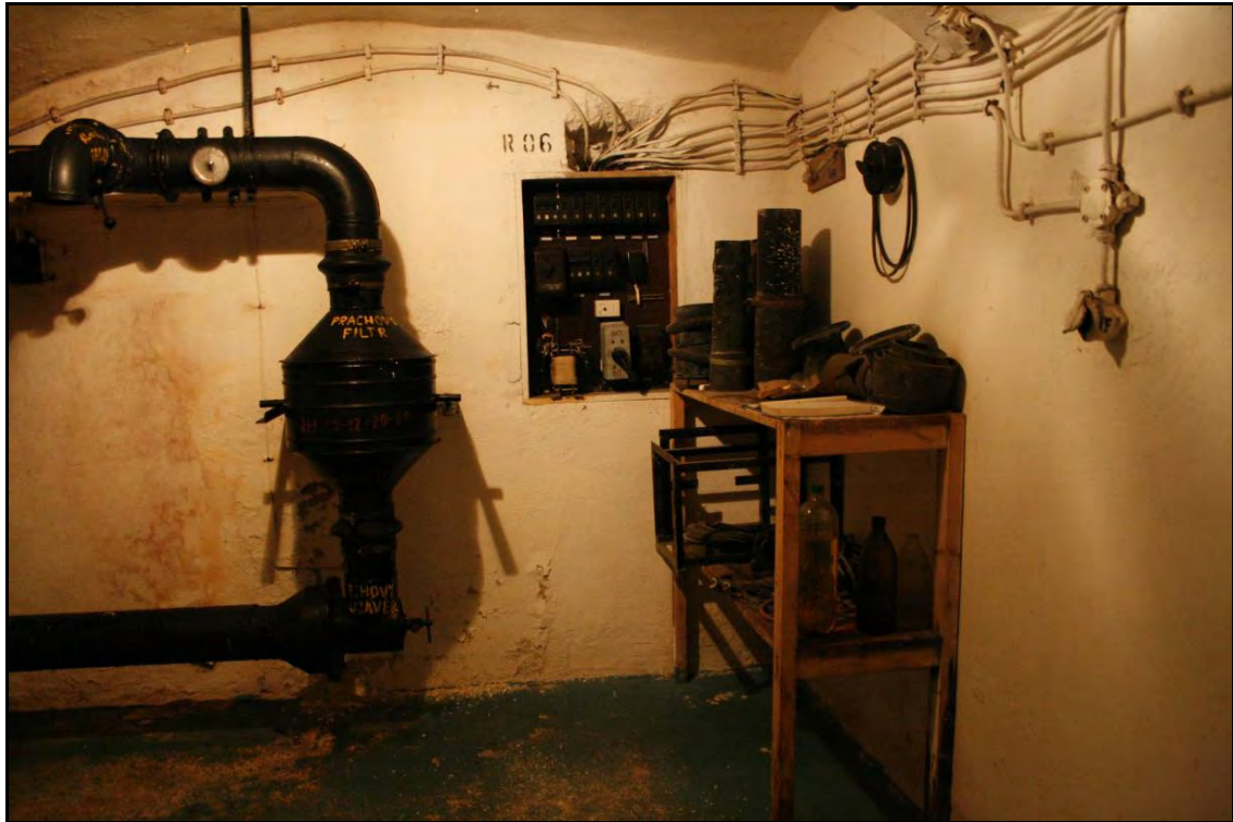
Foto 30 Sklepní prostora 009. Pohled na mechanismus ručního přívodu kyslíku do krytu CO. Foto 6/2011.
