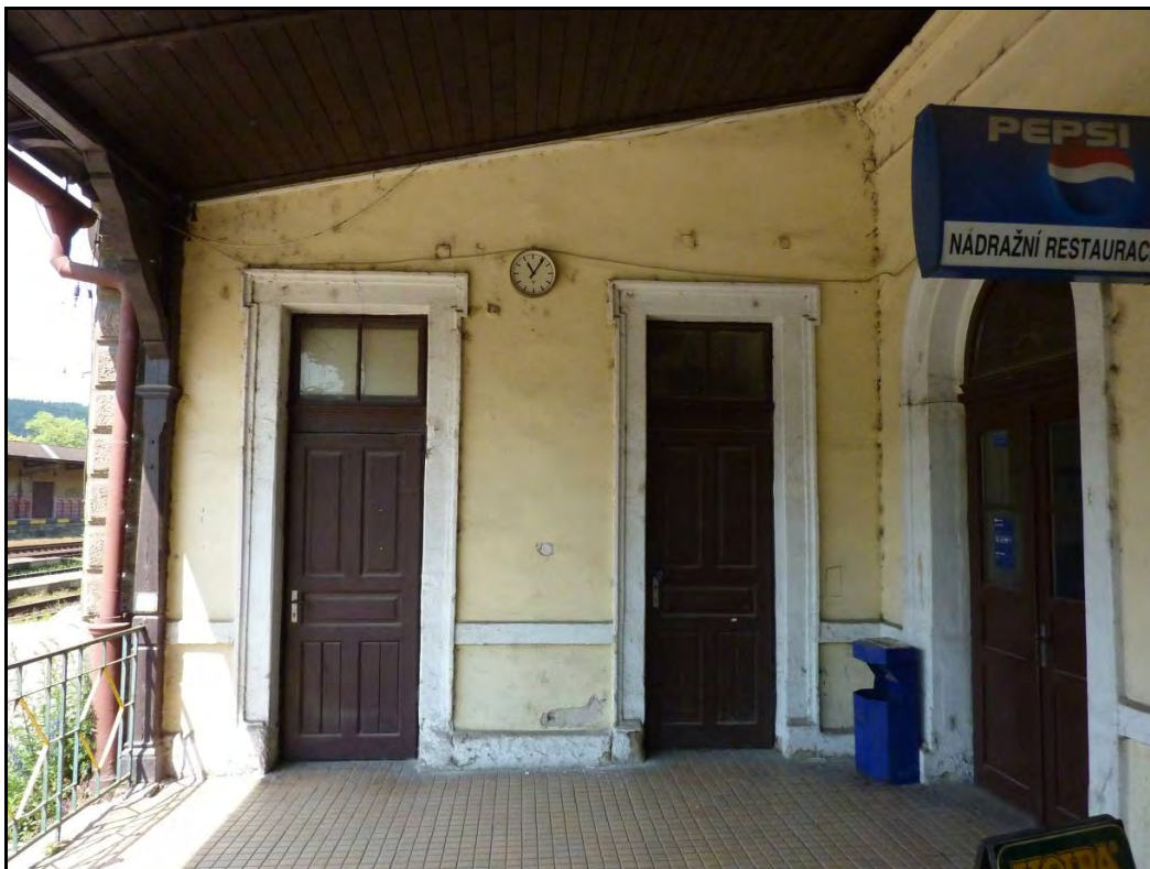
Foto 22 Pohled na východní stěnu v přízemí západního křídla jižního nástupiště. Na fotografii jsou vidět dva vstupy původně zpřístupňující záchody. Foto 6/2011.
