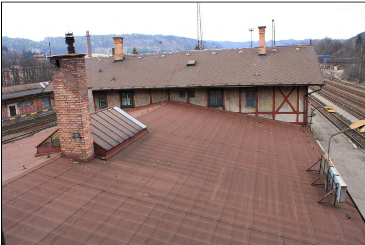
Foto 27 Pohled zastřešení přízemního spojovacího křídla. U komína je vidět prosklený světlík, který původně přiváděl světlo do haly a dnes je v interiéru zaslepený. Střeška nad středním křídlem je kryta barvenou lepenkou. Pod ní je patrné pravidelné zvlnění starší střešní krytiny, snad plechové (nezkoumáno). Foto 6/2011.
